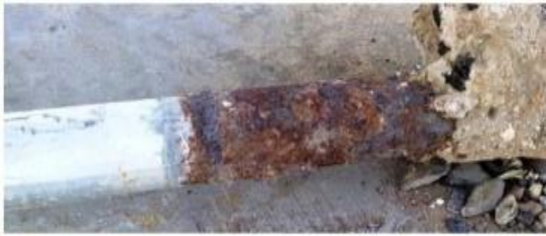
شكل (3) يوضح التآكل الجلفاني
